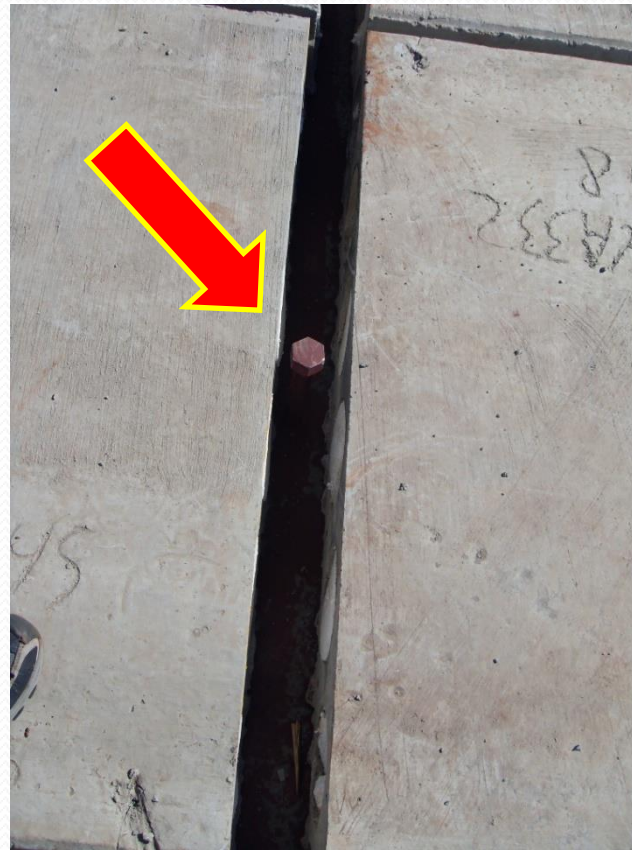
PINO PARA TRAVAMENTO DAS VIGAS METALICAS
